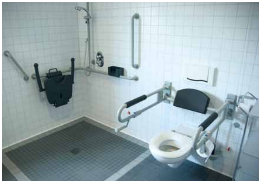
Exemple de la salle de bains d'un des appartements
